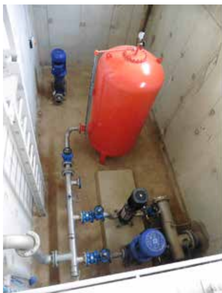
Pompes à la Station d'Eau Industrielle
